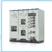
低压抽出式开关柜
